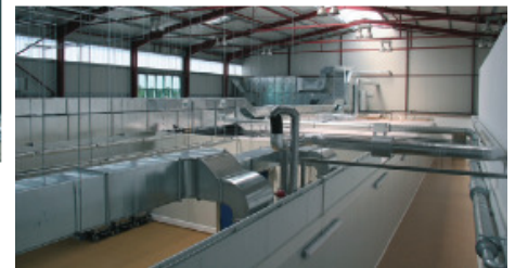
Die neue Spüllogistik erzielt deutliche Kosteneinsparungen.
